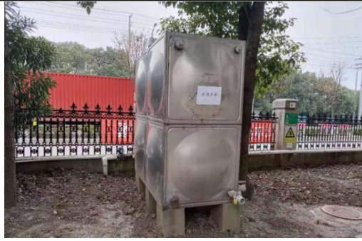
废水站应急水箱
