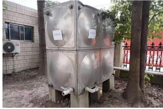
废水站应急水箱
